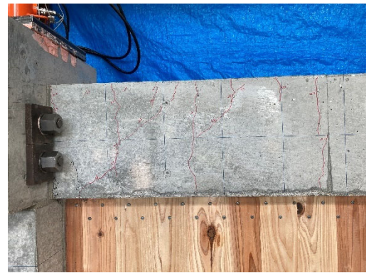
(d) R=5.0 \times 10^{-3} rad 梁左ひび割れ状況
