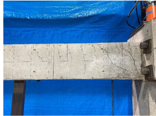
(j) R=33 \times 10^{-3} rad 右梁ひび割れ状況
