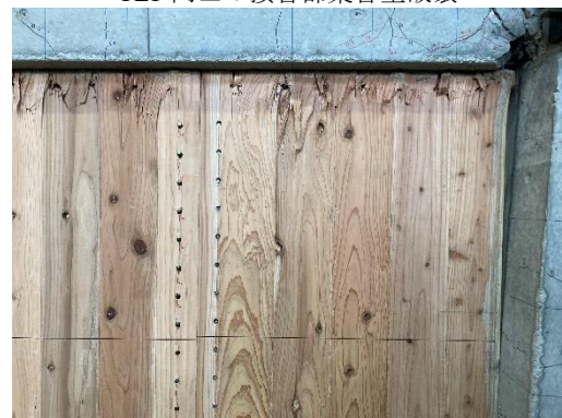
(l) R=50 \times 10^{-3} rad DP 接合部損傷状況
