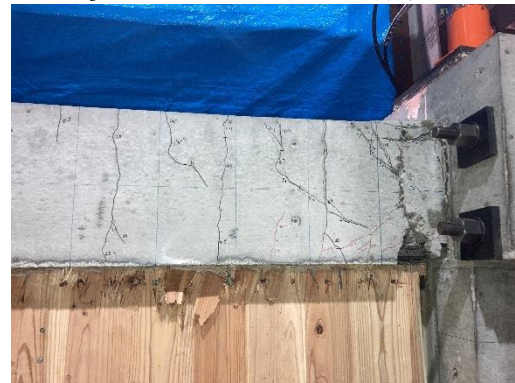
(l) R=50 \times 10^{-3} rad 接合部損傷状況
