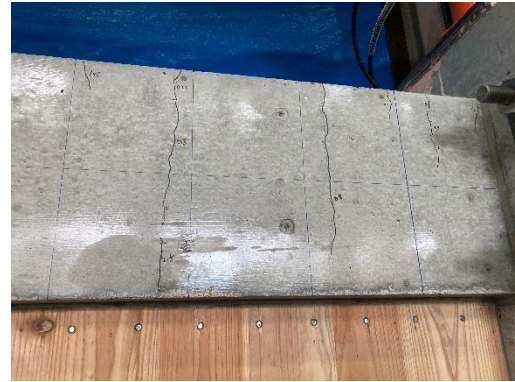
(b) R=2.5 \times 10^{-3} rad 右梁ひび割れ状況
