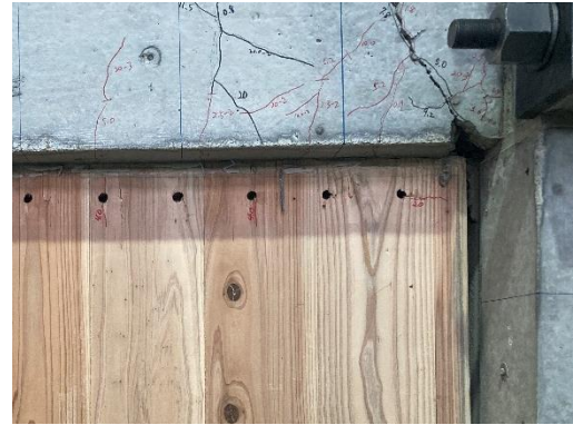
(j) R=33 \times 10^{-3} rad 接合部損傷状況
