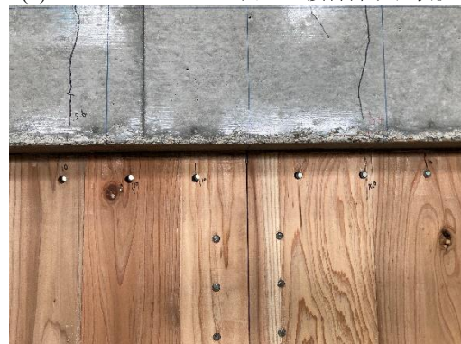
(f) R=10 \times 10^{-3} rad DP 接合部めりこみ状況
