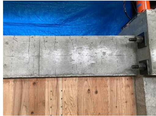
(b) R=2.5 \times 10^{-3} rad 梁右ひび割れ状況
