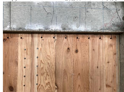
(h) R=20 \times 10^{-3} rad DP 接合部損傷状況
