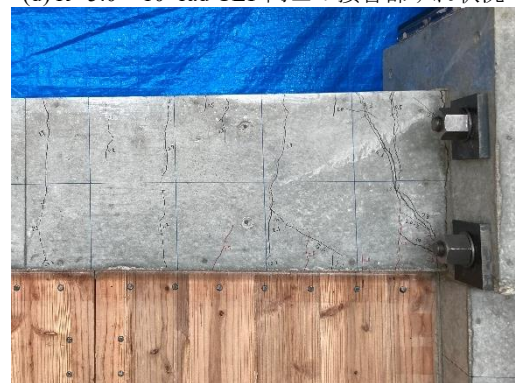
(f) R=10 \times 10^{-3} rad 梁部ひび割れ状況
